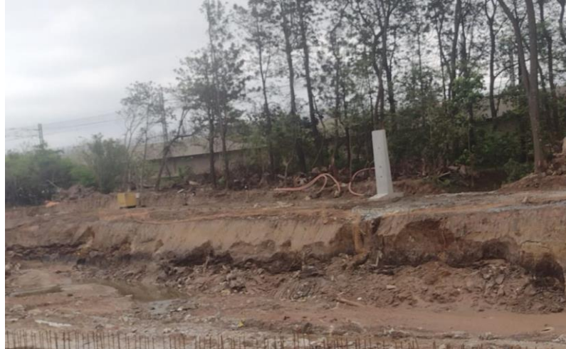
FIGURA 02 – EROSÃO MARGEM ESQUERDA
