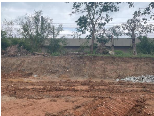
FIGURA 04 – CONTROLE DA EROSÃO NA MARGEM ESQUERDA
