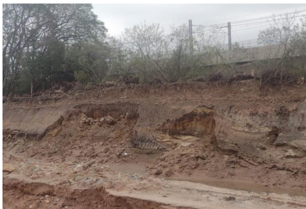
FIGURA 03 – EROSÃO MARGEM ESQUERDA
