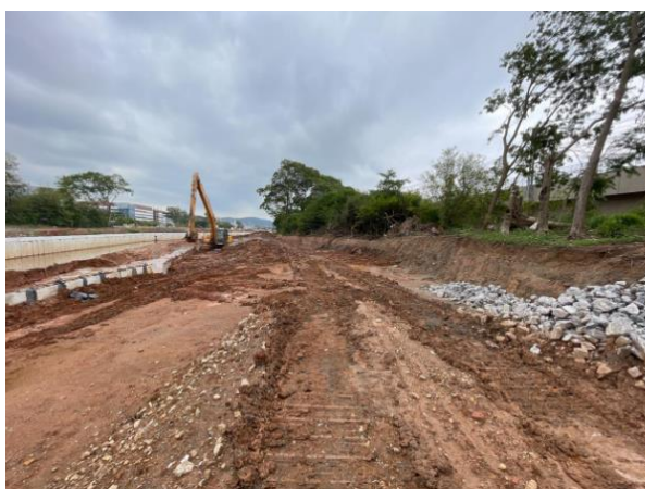
FIGURA 05 – CONTROLE DA EROSÃO NA MARGEM ESQUERDA
