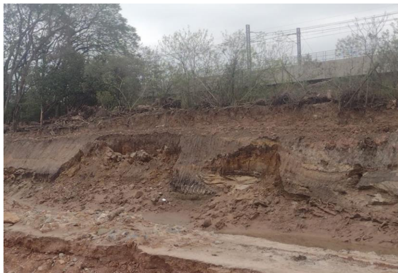
FIGURA 03 – EROSÃO MARGEM ESQUERDA
